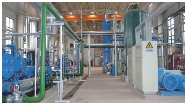
图8 国际首套1.5 MW先进压缩空气储能系统(中国廊坊)
