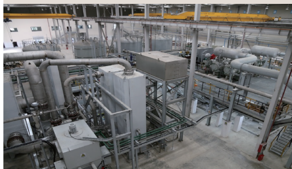
图9 国际首套10 MW先进压缩空气储能系统(中国毕节)
