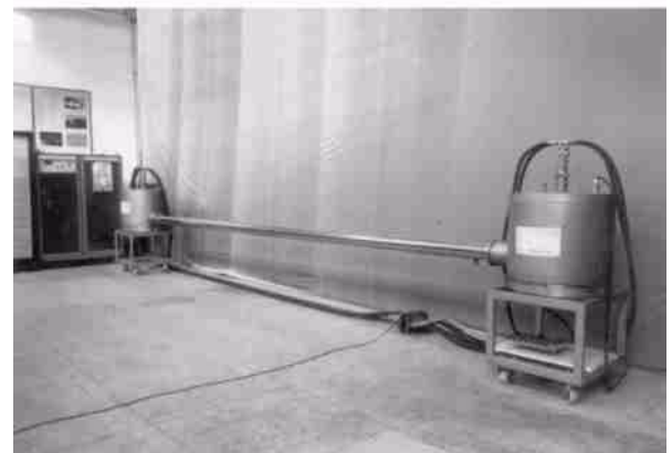
图 2 6m 铋系高温超导直流电缆和终端的外貌
