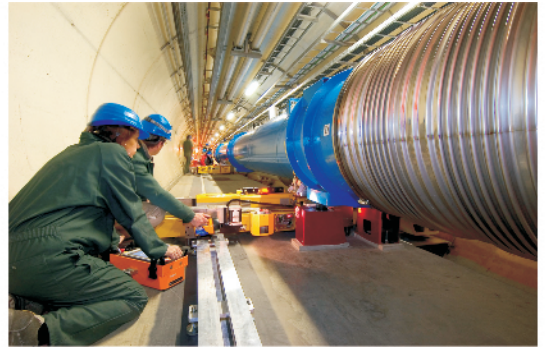
图1 LHC加速器的隧道
