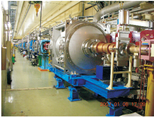
图 5 KEKB 加速器隧道
