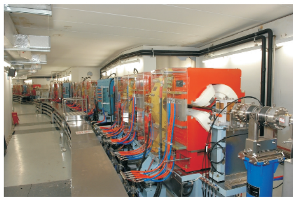
图6 电子储存环一个单元
